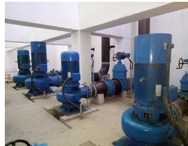
WL提升泵房
