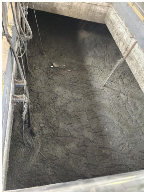
回流泵房 (二沉池污泥回流到生化池)
