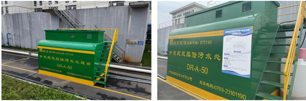
图 4-2 东日环保一体化设备测试运行前（左）后（右）设备表面情况
