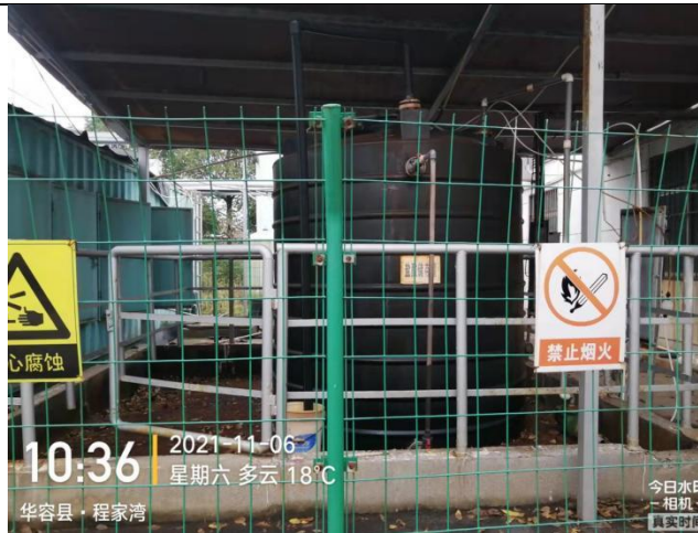
1号盐酸储罐罐
